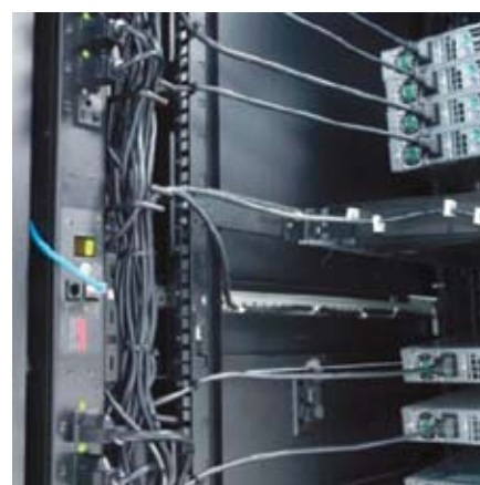
РИС. 1. БЛОК РАСПРЕДЕЛЕНИЯ ПИТАНИЯ (БРП), СМОНТИРОВАННЫЙ В МОНТАЖНОМ ШКАФУ
